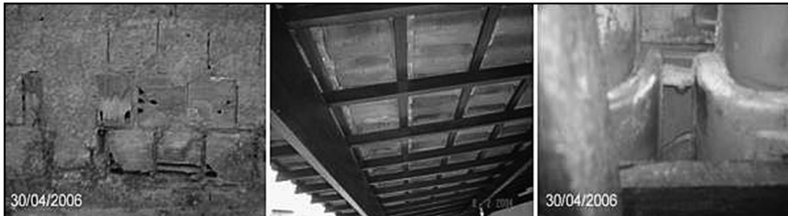
Figura 1. a) Meteorización acelerada en ladrillos; b) material cerámico afectado por hongos; c) grietas en azulejo cerámico. Figure 1. a) Rapid degradation in bricks; b) fungus spread out; and c) cracks in the tile ceramic.
