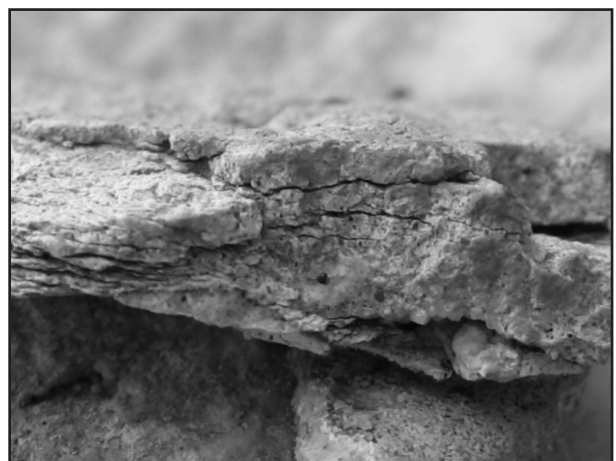
Figura 9. Desplacado de la cornisa que separa la planta alta de la baja. Es visible en su interior la presencia de una fuerte fisuración que delimita múltiples escamas. Figure 9. Spalling of the cornice that separates the high floor of the ground floor. It is visible in its inside the presence of one strong fissure that delimits multiple flakes.
