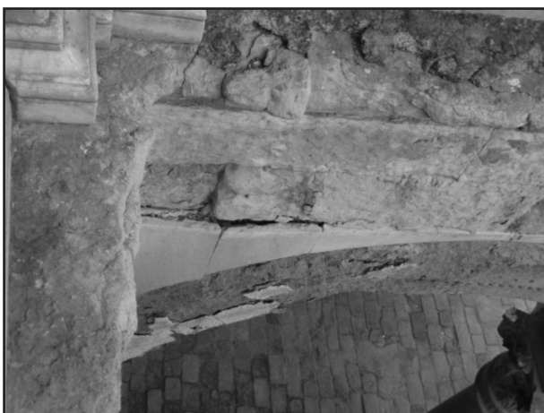
Figura 8. Las placas de mármol corren peligro de caída, al estar en muy mal estado la piedra caliza que la soporta. Figure 8. The marble slabs are in danger of falling, when is in very poor condition the limestone that it supports.
