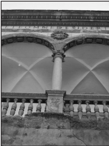
Figura 6. Detalle del estado de conservación de una de las fachadas del patio. Los mayores deterioros se concentran bajo la trayectoria de caída del agua desde el tubo de evacuación. La pérdida de material pétreo afecta principalmente a la piedra caliza local.
