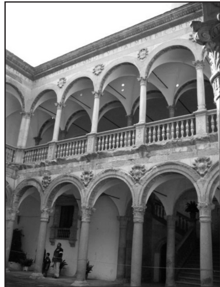
Figura 2. Fachada Oeste del patio central, con la escalera principal a la derecha. Los signos de deterioro en la decoración de las arcadas de la planta baja son muy visibles y afectan a la misma variedad pétreo.
