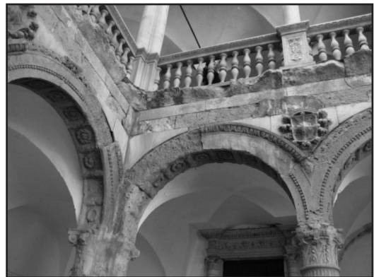
Figura 7. Deterioros en una de las esquinas de la planta baja del patio. La piedra caliza local es la más afectada por la agresión del agua de lluvia y el viento.
