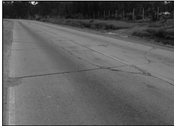
Figura 3. Sector del proyecto con severo nivel de agrietamiento. Figure 3. Severely cracked length of road.
