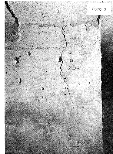
FOTO 3. —Grieta vertical y fisuras en cabeza de pilar. Las armaduras están colocadas correctamente.
