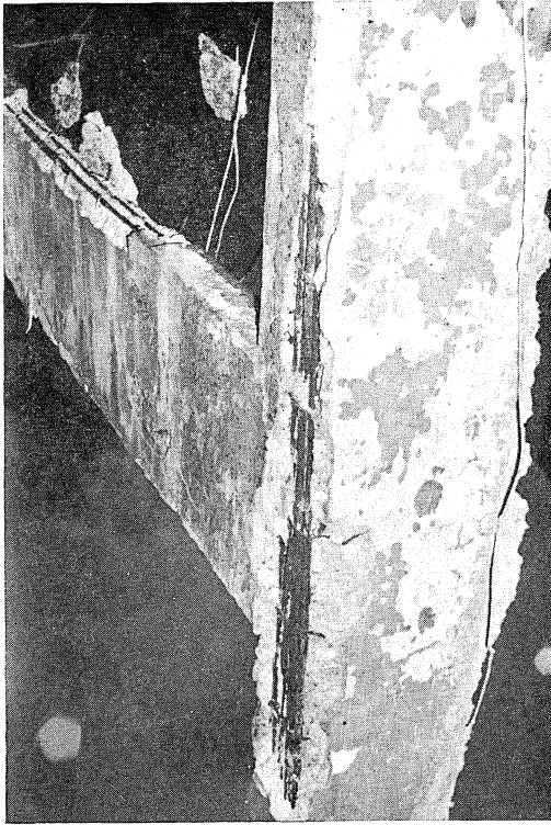
FOTO 3. CASO 1.—Corrosión de armaduras en la estructura.
