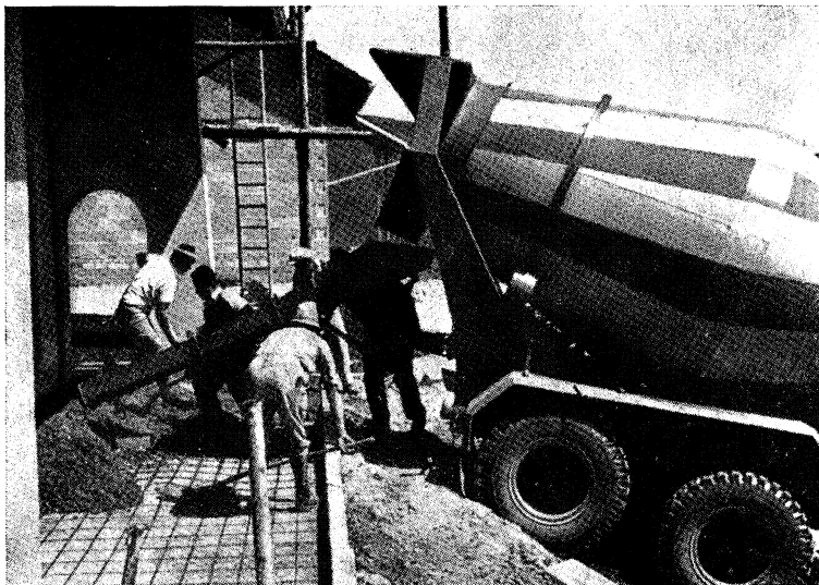
Fig. 8.—Entrega inmediata del hormigón preparado desde un vehículo-hormigonera, a través de una rampa, al elemento a hormigonar.
