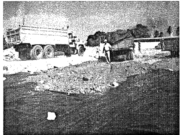
Figura 5.- Urbanización La Coromoto. Construcción de barrera horizontal de humedad. Figure 5.- La Coromoto neighborhood. Construction of horizontal barrier of humidity.
